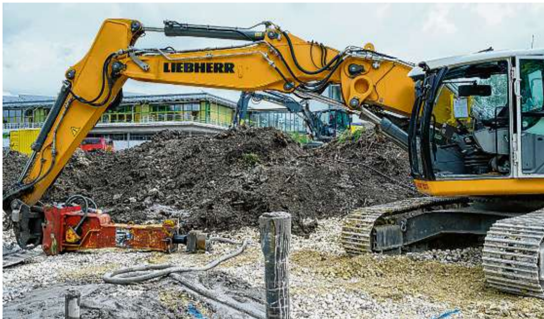
Ab sofort sind die Bagger aktiv: Die Erweiterung der Gerhard-Thielcke-Realschule (im Hintergrund) soll ab November 2020 nutzbar sein. BILD: GERALD JARAUSCH
